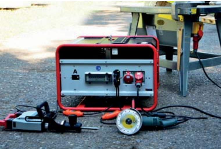
Abb. 24 Drei Betriebsmittel – Baustellenkreissäge direkt angeschlossen, Abbruchhammer und Winkelschleifer mit jeweils einer zwischengeschalteten PRCD
