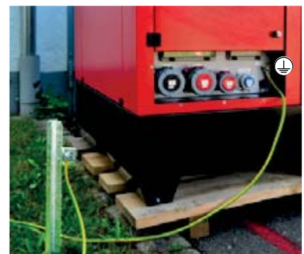
Abb. 15 Stromerzeuger mit Erdungsanschluss und Erdspieß
