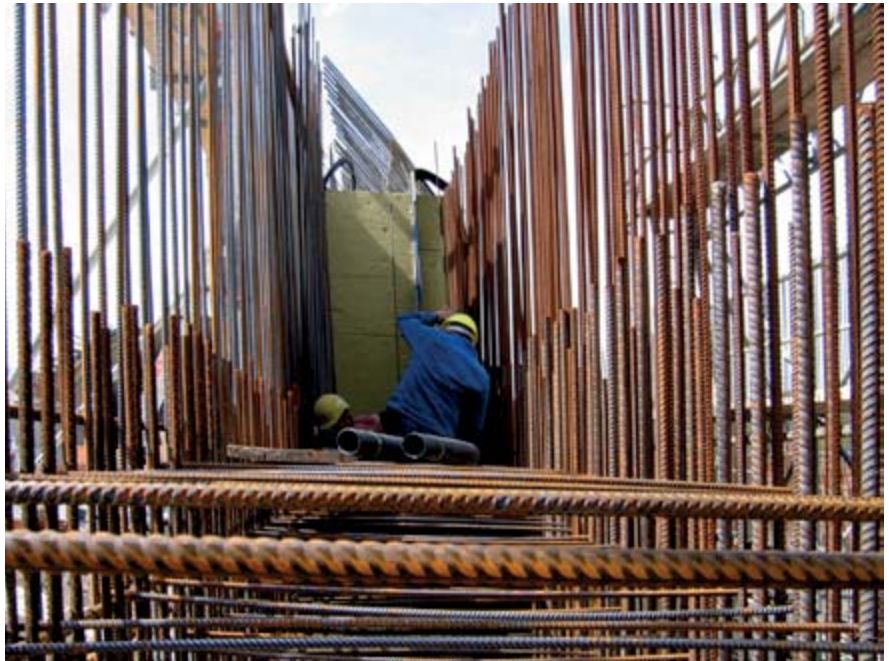
Abb. 19 Beispiel für erhöhte elektrische Gefährdung
