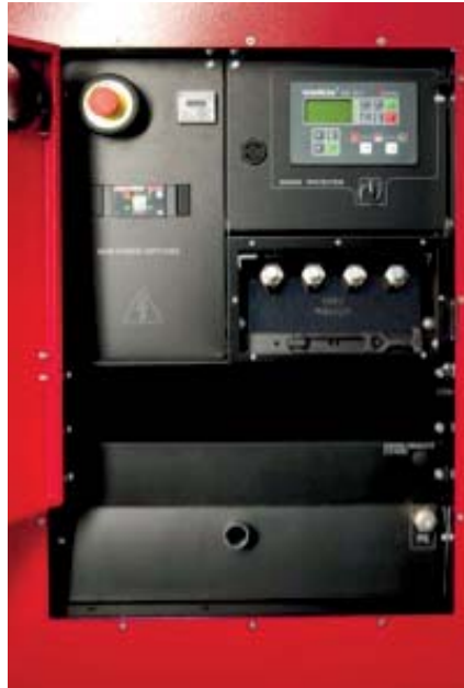
Abb. 16 Stromerzeuger mit Überschutz-einrichtung, aber ohne integrierte Maßnahmen zum Personenschutz
