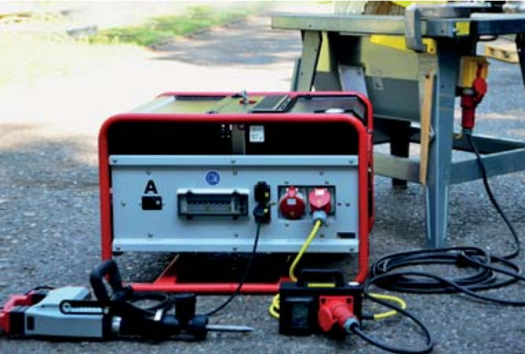
Abb. 23 Zwei Betriebsmittel – Abbruchhammer direkt angeschlossen, Baustellenkreissäge mit zwischengeschalteter vierpoliger RCD in einem Verteiler
