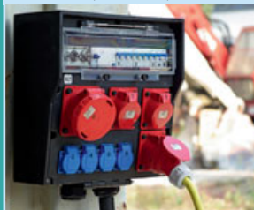
Stromverteiler mit Steckdosen (stationär)
