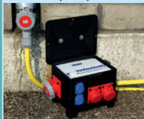
Stromverteiler mit Steckdosen (mobil)
