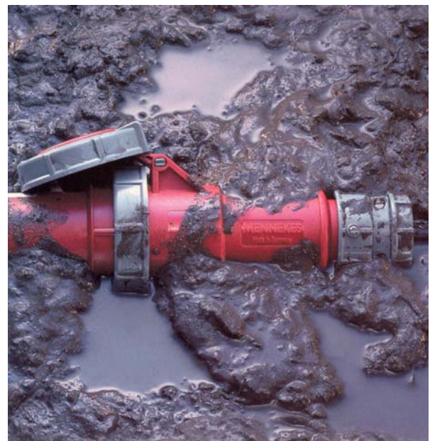
Bild 7): Unzureichender Feuchtigkeitsschutz der Steckverbindung
