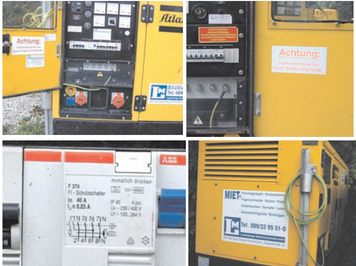
Abb. 3: Ersatzstromerzeuger mit Fehlerstromschutzeinrichtung und Erdspieß
