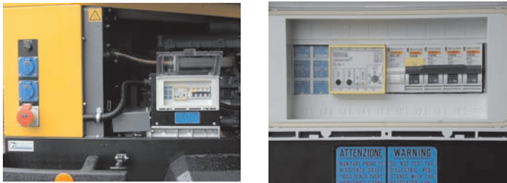
Abb. 11: Ersatzstromerzeuger mit Isolationsüberwachungs- und Abschaltvorrichtung
